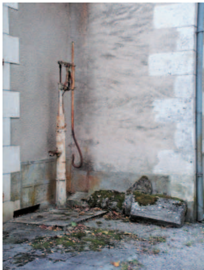
Pompe à eau à Azay-le-Ferron
