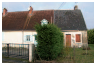
Aspect disparate des clôtures et constructions aux façades dégradées aux franges du bourg
