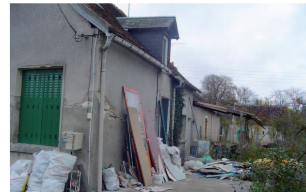
Franges arrière du bourg à l'aspect négligé, altérant l'image de l'espace public
